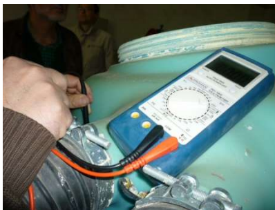
Foto 8. Todos los elementos metálicos están conectados por un conductor
