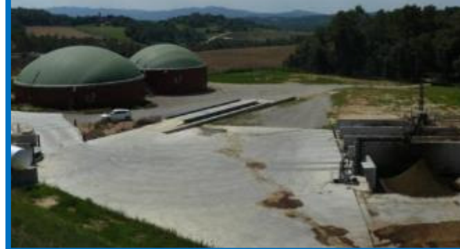
Planta de co-digestión y compostaje en granja de vacuno de Leche (Girona)
