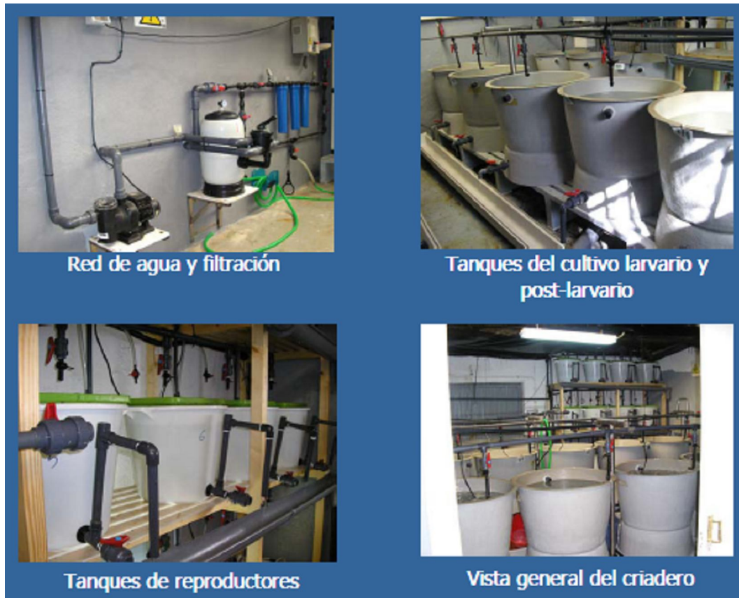
Figura 25. Imágenes del sistema de captación, filtración y esterilización de las instalaciones para el mantenimiento de los reproductores y cultivo larvario
